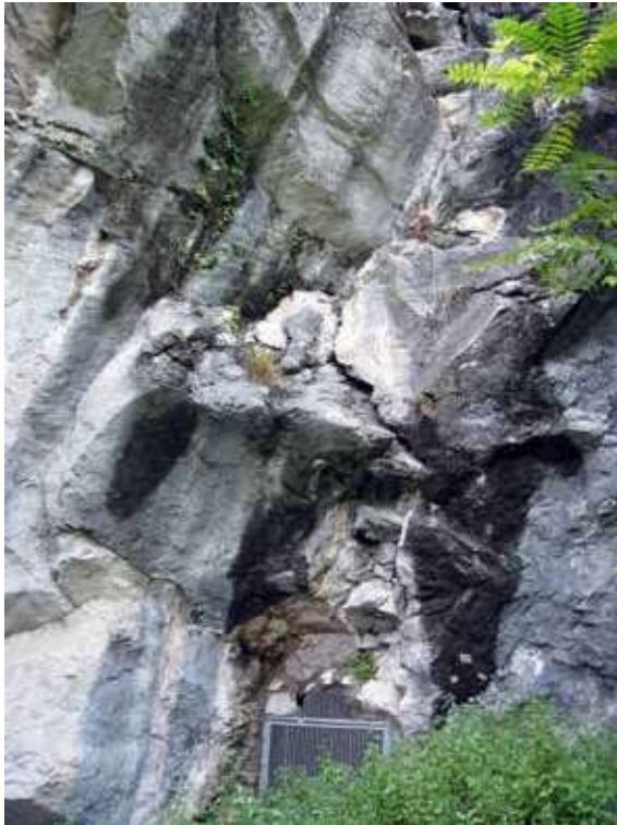
La crevasse vista da fuori.
